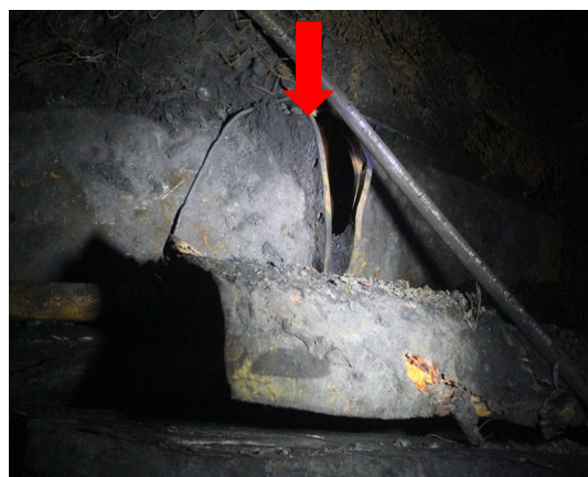
(b) 抽放管路损坏
