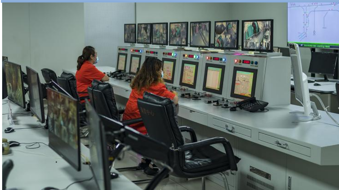
提升集控操作
