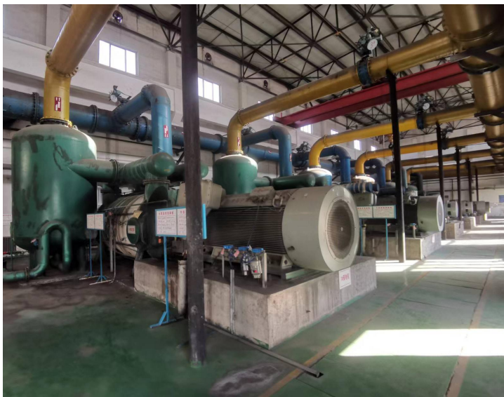
瓦斯抽采泵站
