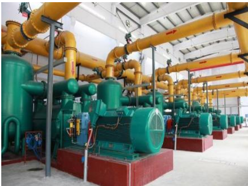
瓦斯抽采泵站现场
