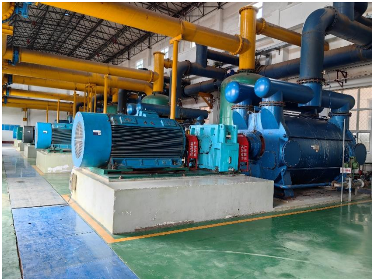
瓦斯抽采泵站水环真空泵
