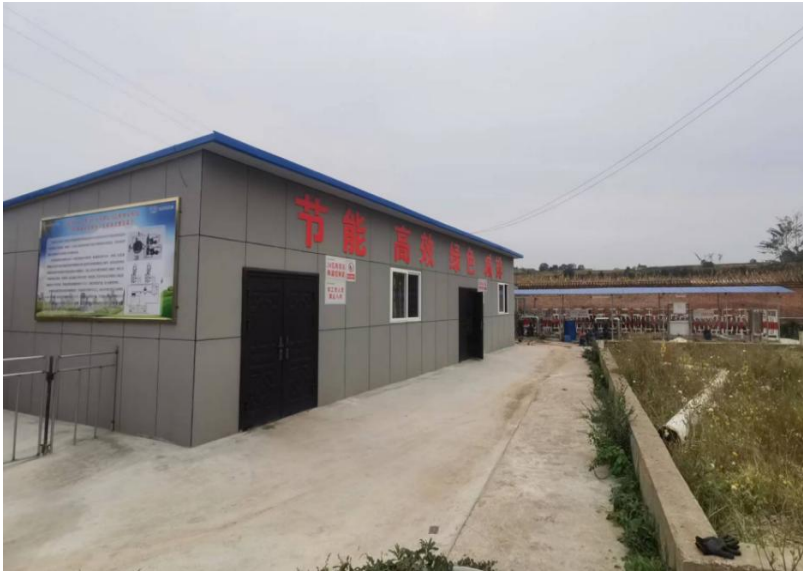
瓦斯抽采泵站系统现场
