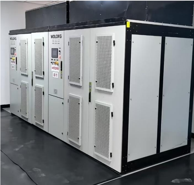
泵高效运行调控柜
