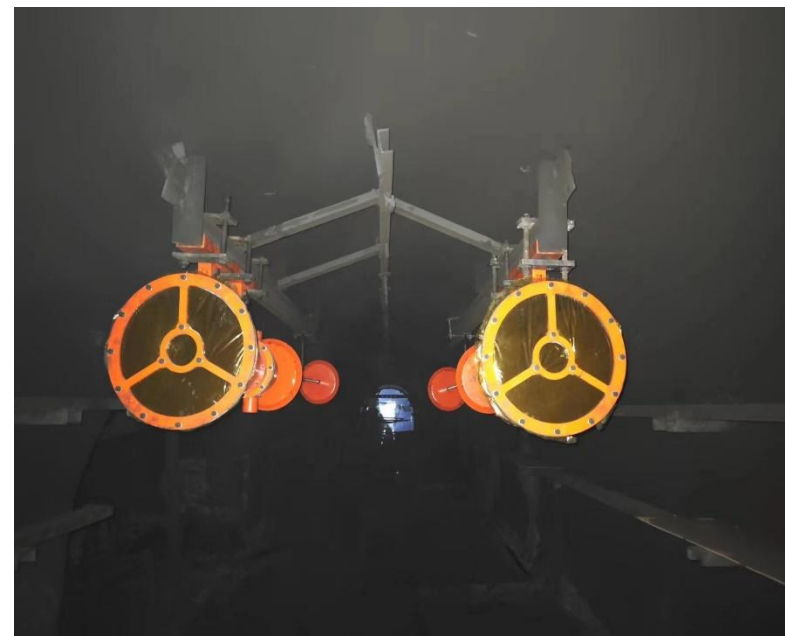
CO消纳剂喷洒装置
