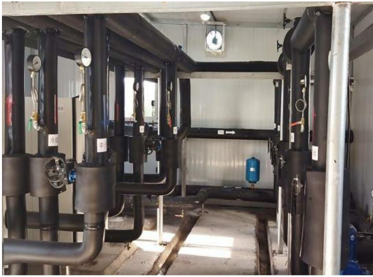
低温热泵及管路系统
