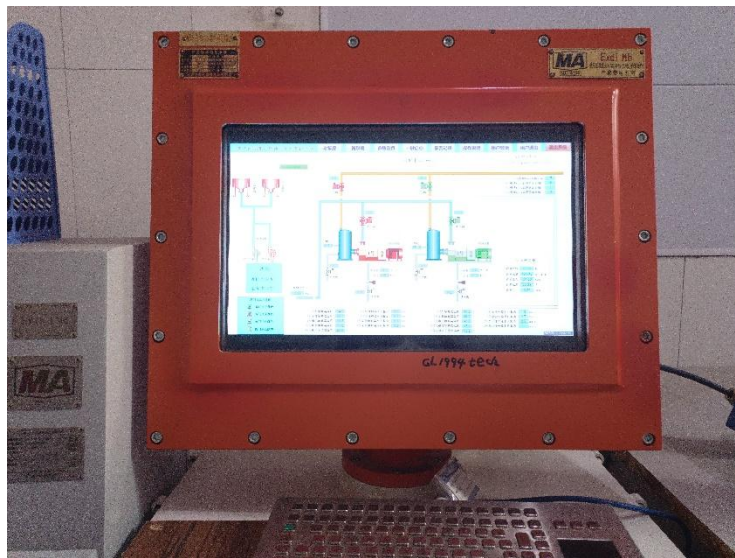
抽采泵站智能监控系统
