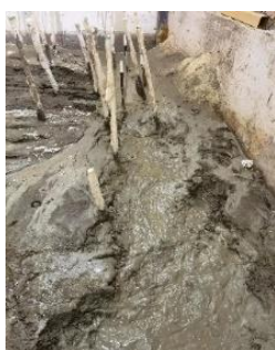
尾矿坝冲刷溃口
