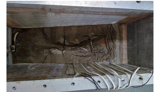
尾矿坝最终破坏形态（俯视）
