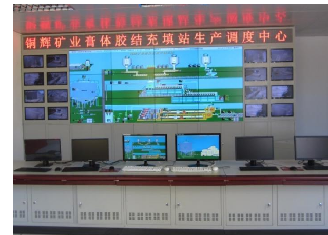
自动化控制室
