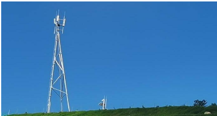
通讯基础设施
