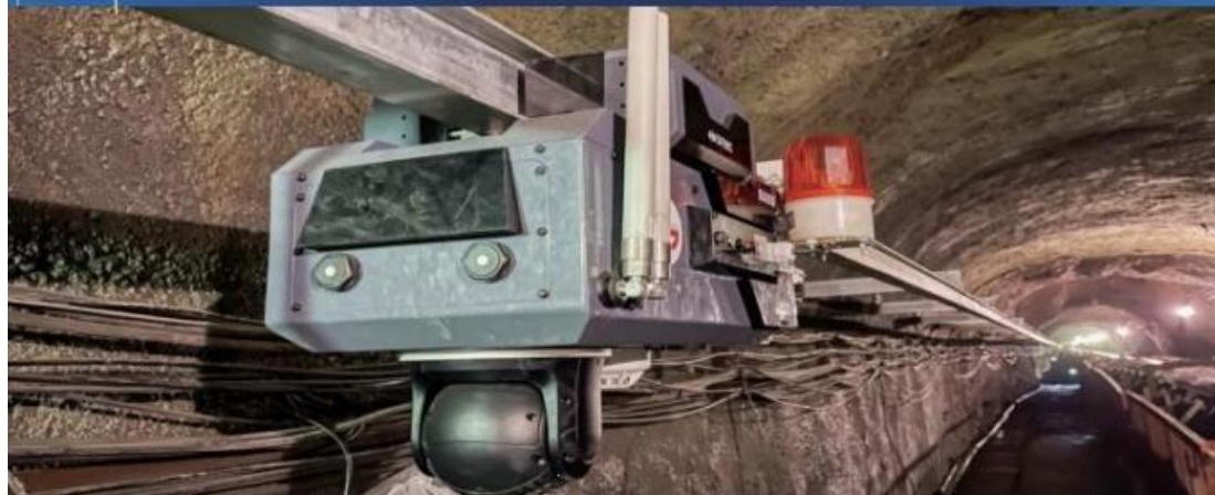
首钢硼铁5G智能矿山项目中的应用
