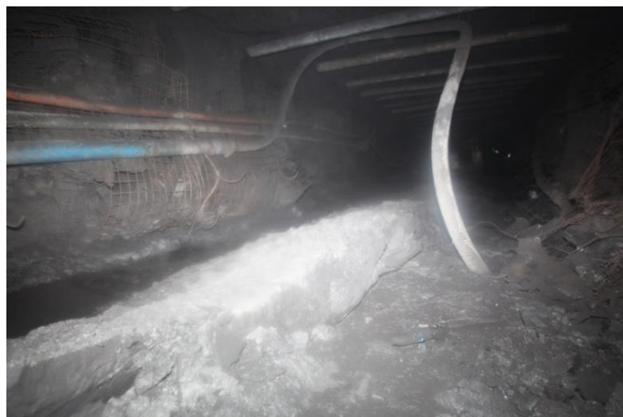
巷道严重底鼓，支护系统失效 (超前120-350m)
