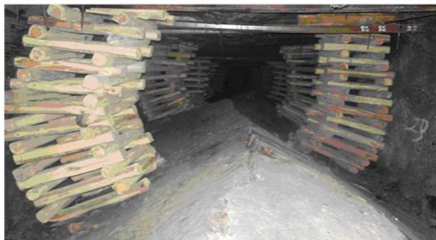
(d) 内蒙古巴彦高勒煤矿回风巷变形
