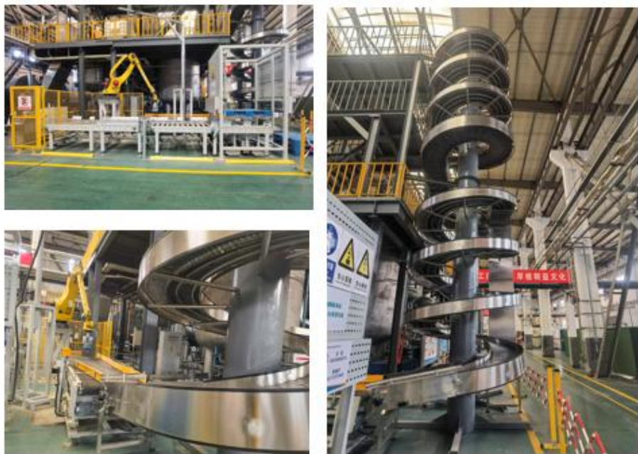
有机-无机复合注浆材料生产装置
