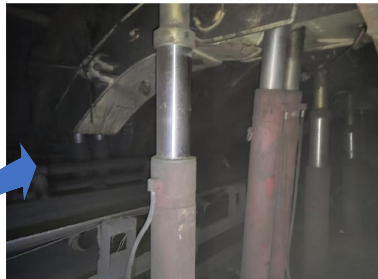
锚网索+36U钢+六柱式全断面防冲吸能支架
